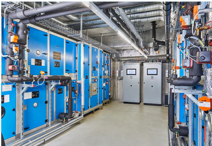
Système de ventilation et de climatisation avec divers composants Belimo
