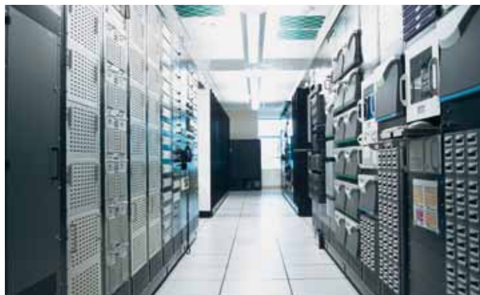
Datacentra/ Critical Power
