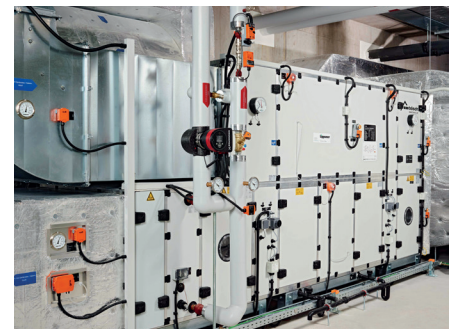
Lüftungsanlage, ausgerüstet mit Sensoren, Klappenantrieben und elektronisch druckunabhängigen Regelkugelhähnen EPIV von Belimo.
