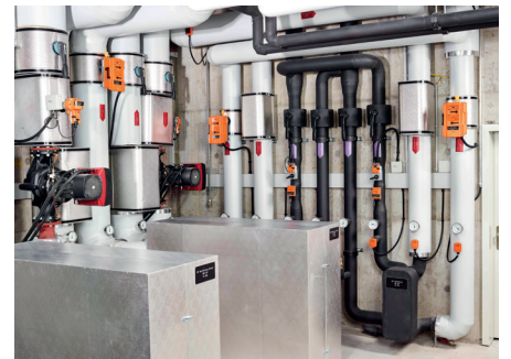
Dichtschiessende Belimo-Absperrklappen in der Kühl- und Heizzentrale.
