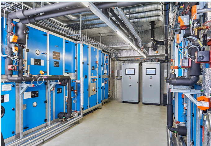
RLT-Anlage mit verschiedenen Belimo-Komponenten
