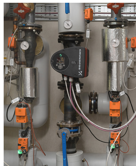
Schaltung mit Belimo Energy Valves, vor Ort gebaut.
